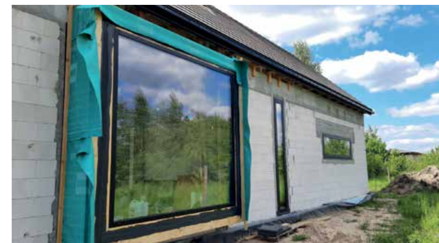
Duży fix, zamontowany z wysunięciem 500 mm w stosunku do elewacji, umieszczony w bocznej ścianie budynku.
